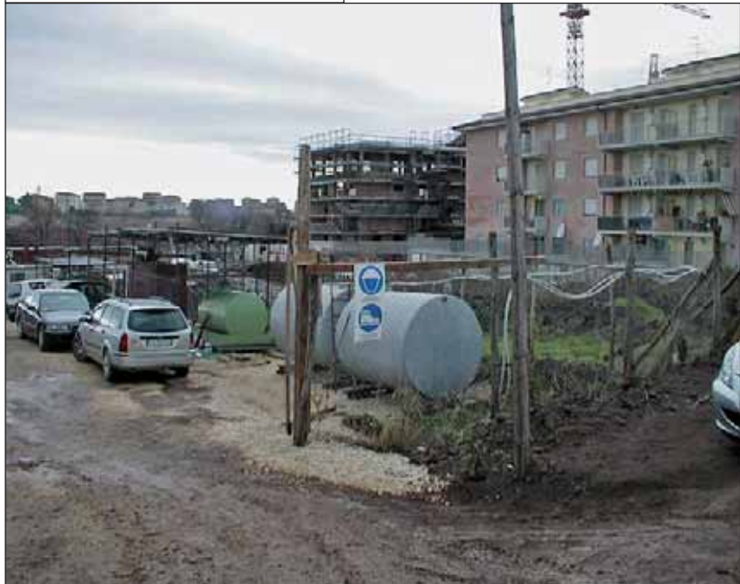
Serbatoio acqua non potabile
